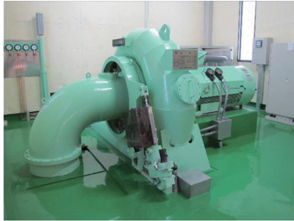
横軸フランシス水車の設置事例
