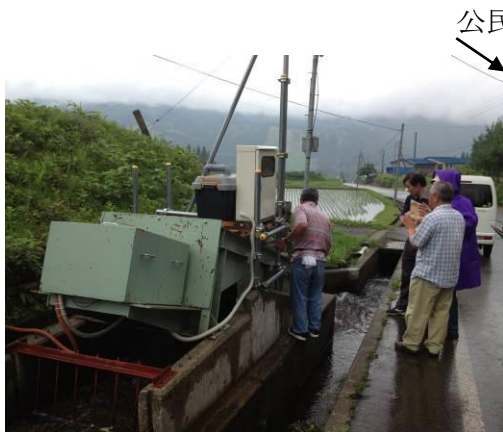
図 4.4.7 小水力発電の電気を公民館に送電
