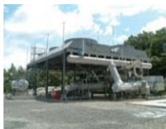
バイナリー発電設備2,000kW
