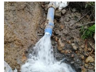
災害で破断した水道管
