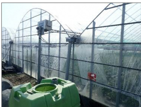
防犯カメラの設置
