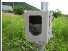
防犯カメラの設置
