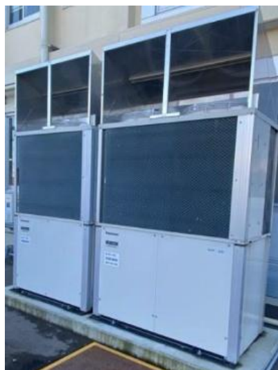
室外機 23台 （1階 9台、3階 14台）
