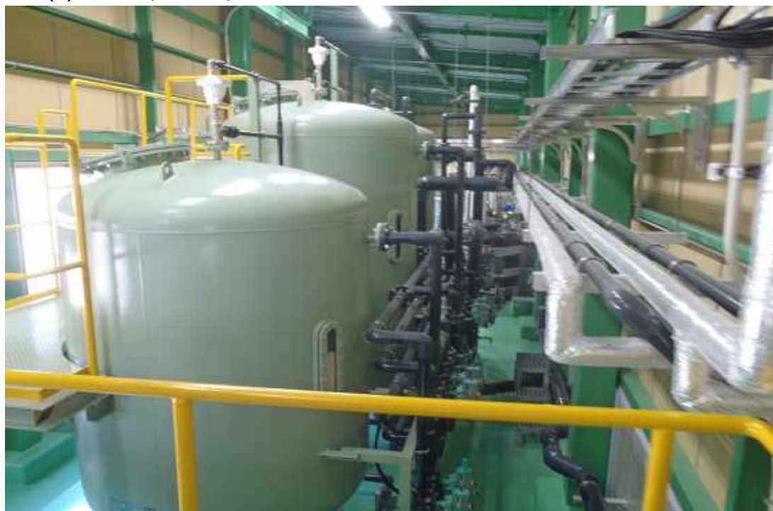
(I) 竣工（内部） 重金属対策設備
