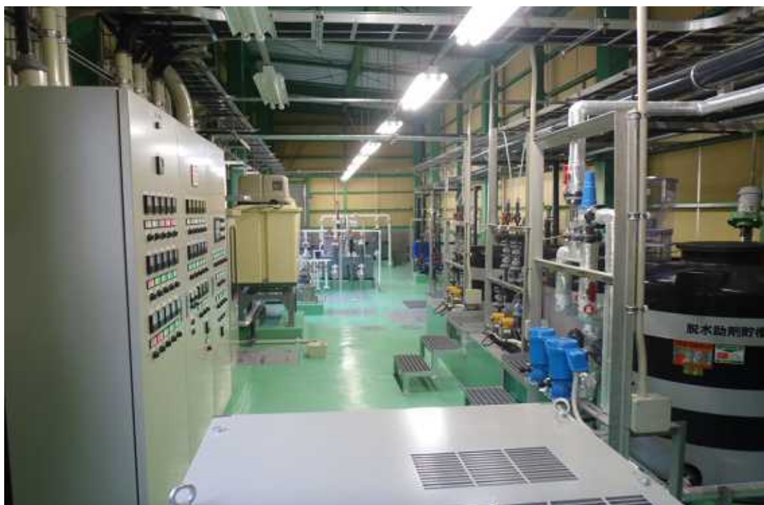
(ウ) 竣工（内部） 生物処理設備
