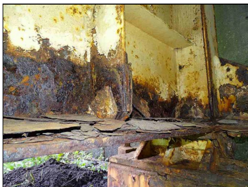
鋼桁の腐食等
