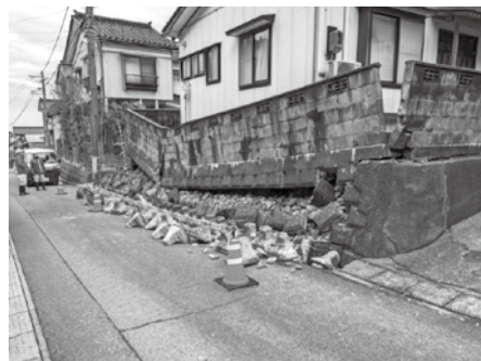
塀垣・造成ブロックの崩落
