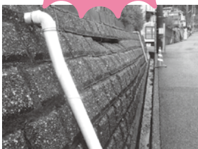
造成ブロックの変形
