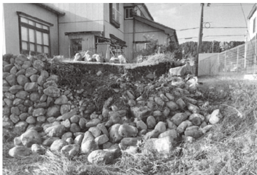
石積み擁壁の崩落
