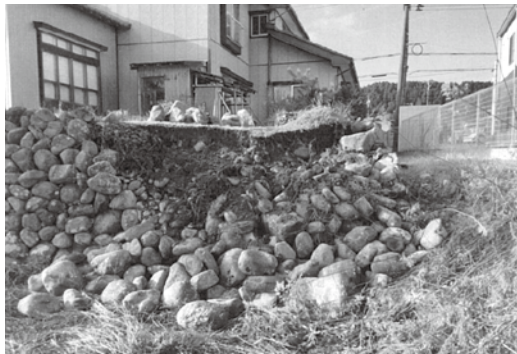
石積み擁壁の崩落
