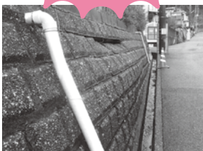
造成ブロックの変形
