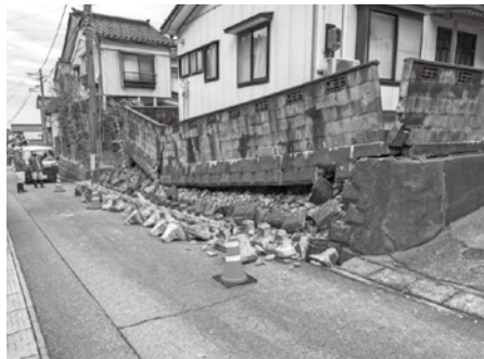
塀垣・造成ブロックの崩落
