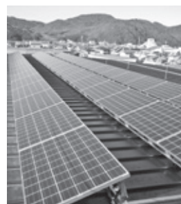
太陽光発電設備 (埴川コミュニティスポーツセンター屋上)
