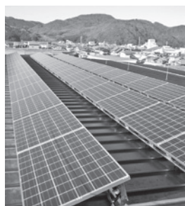
太陽光発電設備 (姫川コミュニティスポーツセンター屋上)
