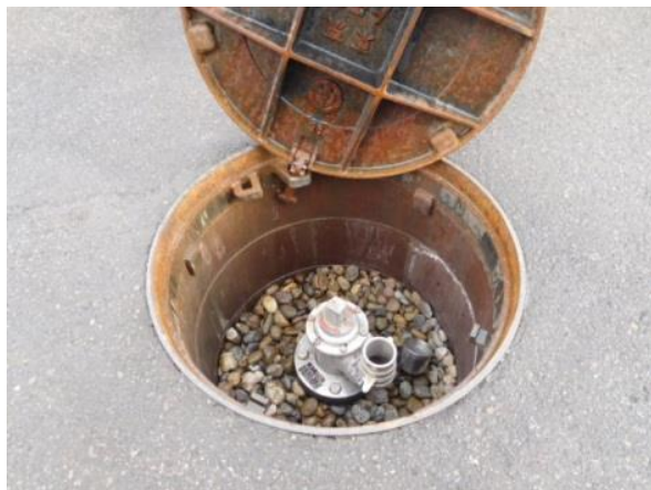
地下式消火栓
