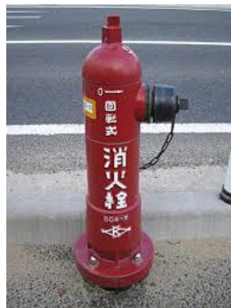
地上式消火栓
