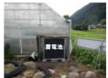
蓄電池 (9.6kWh) に充電
