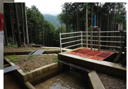
落合平石小水力発電所
