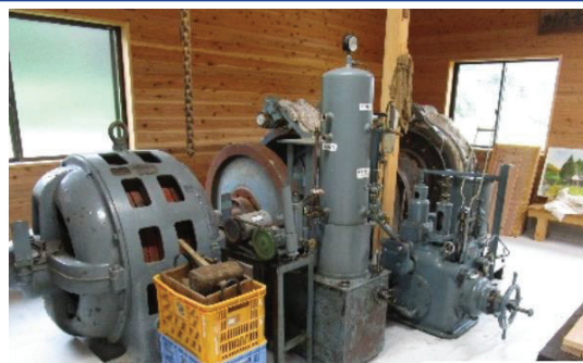
展示室内の旧発電所の水車
