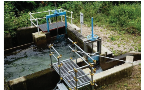
落合平石小水力発電所
