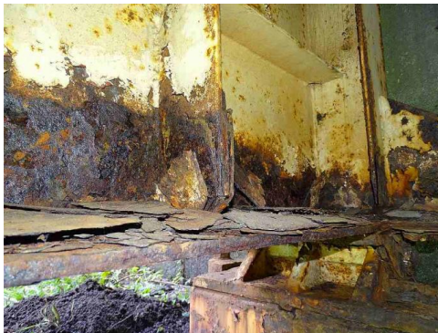
鋼桁の腐食等
